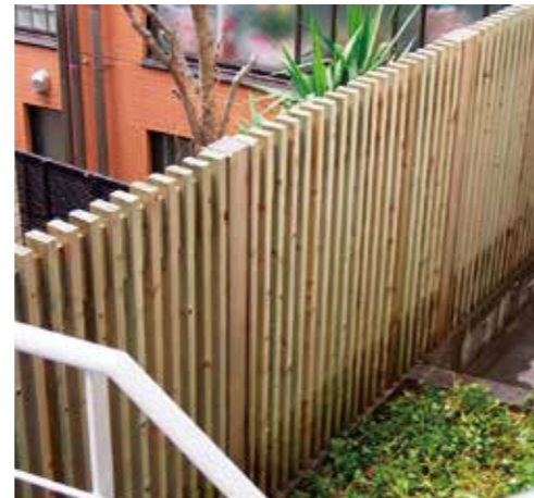
42x85角と42角 小間入格子 H1600 既設基礎の上に既存の支柱を利用して施工
