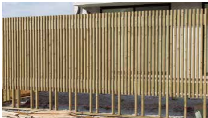
42x85角と30x60角 小間入格子 H1680 フェンスを立てた後に、型枠を組んでコンクリート流し込み (工事中写真)
